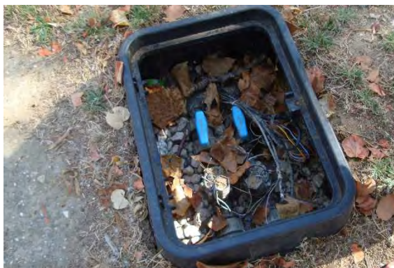
Figura 6.59 – Caixa de gestão do sistema de rega: situação em 2018-09-18
