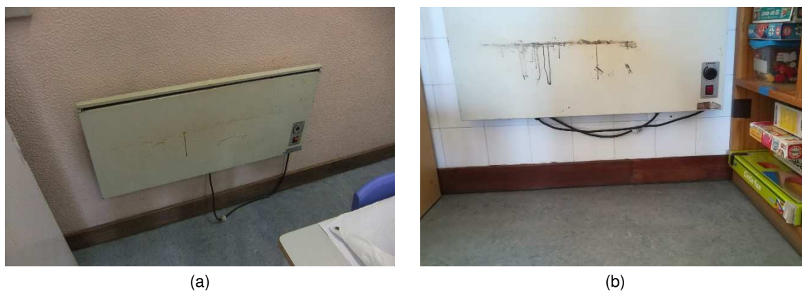
Figura 6.80 – Equipamentos de aquecimento: situação em 2018-10-25 (a); situação em 2019-05-30 (b)
