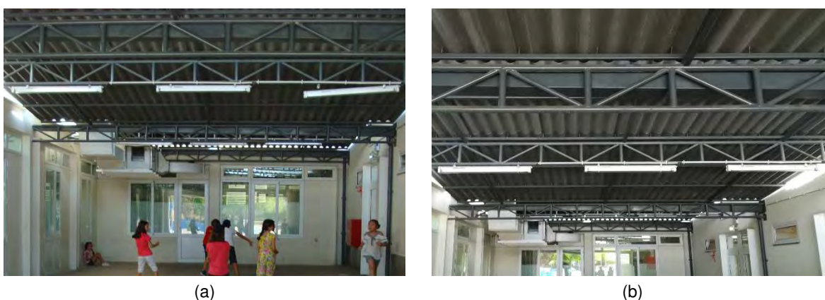
Figura 6.66 – Luminárias do recreio coberto: situação em 2018-10-11 (a); situação em 2019-05-21 (b)
