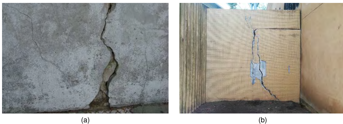
Figura 5.35 – Exemplos de muros exteriores com fendas de grandes dimensões e com risco de instabilidade: EB S. José (a); EB Vale de Alcântara (b)
