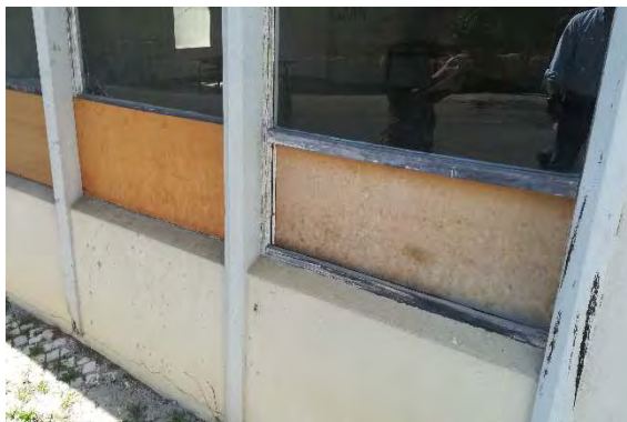
Figura 6.3 – Janela do Pavilhão 3 com vidro partido: situação em 2019-05-21
