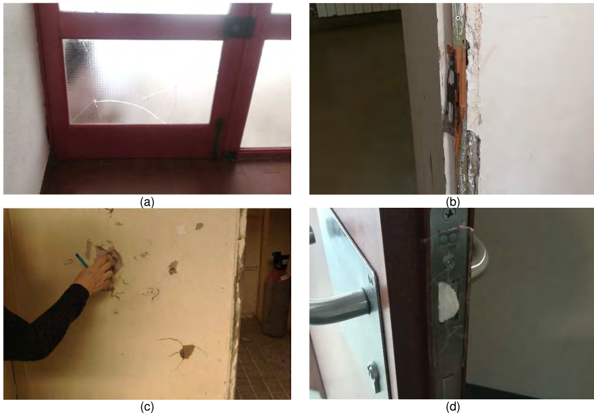
Figura 5.21 – Exemplos de caixilharias interiores com anomalias: EB Adriano Correia de Oliveira (a); EB António Nobre (b); EB Lisboa n.º 72 (c); e EB Parque Silva Porto (d)
