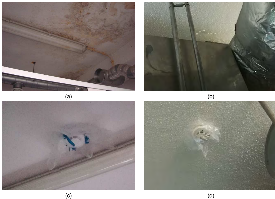
Figura 6.23 – Teto da cozinha: situação em 2018-09-11 (a); situação em 2019-05-21 (b)
