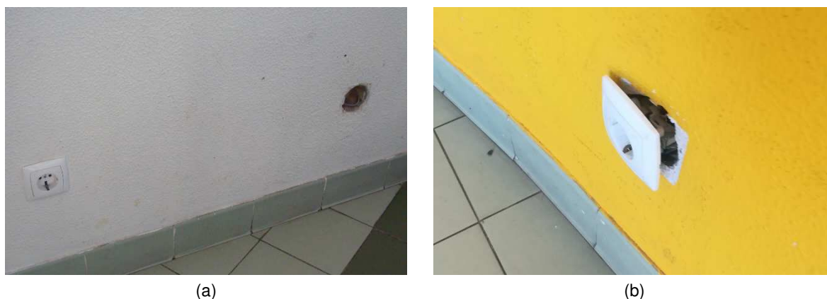
Figura 6.74 – Tomadas no edifício mais recente: situação em 2018-10-18 (a); persistem algumas situações em 2019-05-30 (b)
