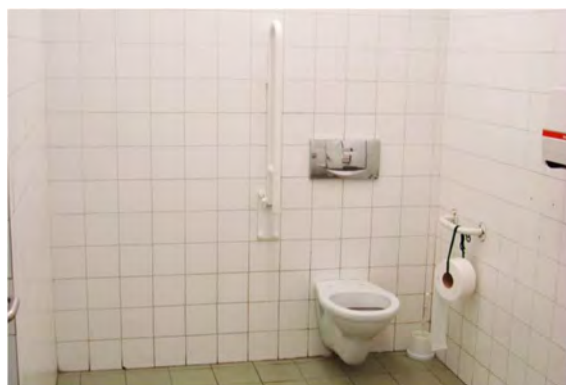
Figura 5.59 – Ausência de fio de alarme em instalação sanitária para pessoas com mobilidade condicionada (EB Santo Condestável)
