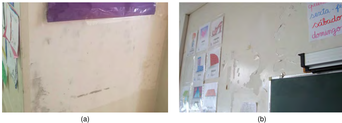
Figura 5.25 – Exemplos de revestimentos de pintura com destacamentos devido à colagem de trabalhos: EB das Laranjeiras (a); EB Lumiar – Alto da Faia (b)
