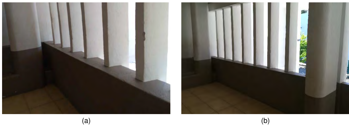
Figura 6.42 – Parapeito na continuação de escadas exteriores: situação em 2018-10-04 (a); situação inalterada, em 2019-05-30 (b)
