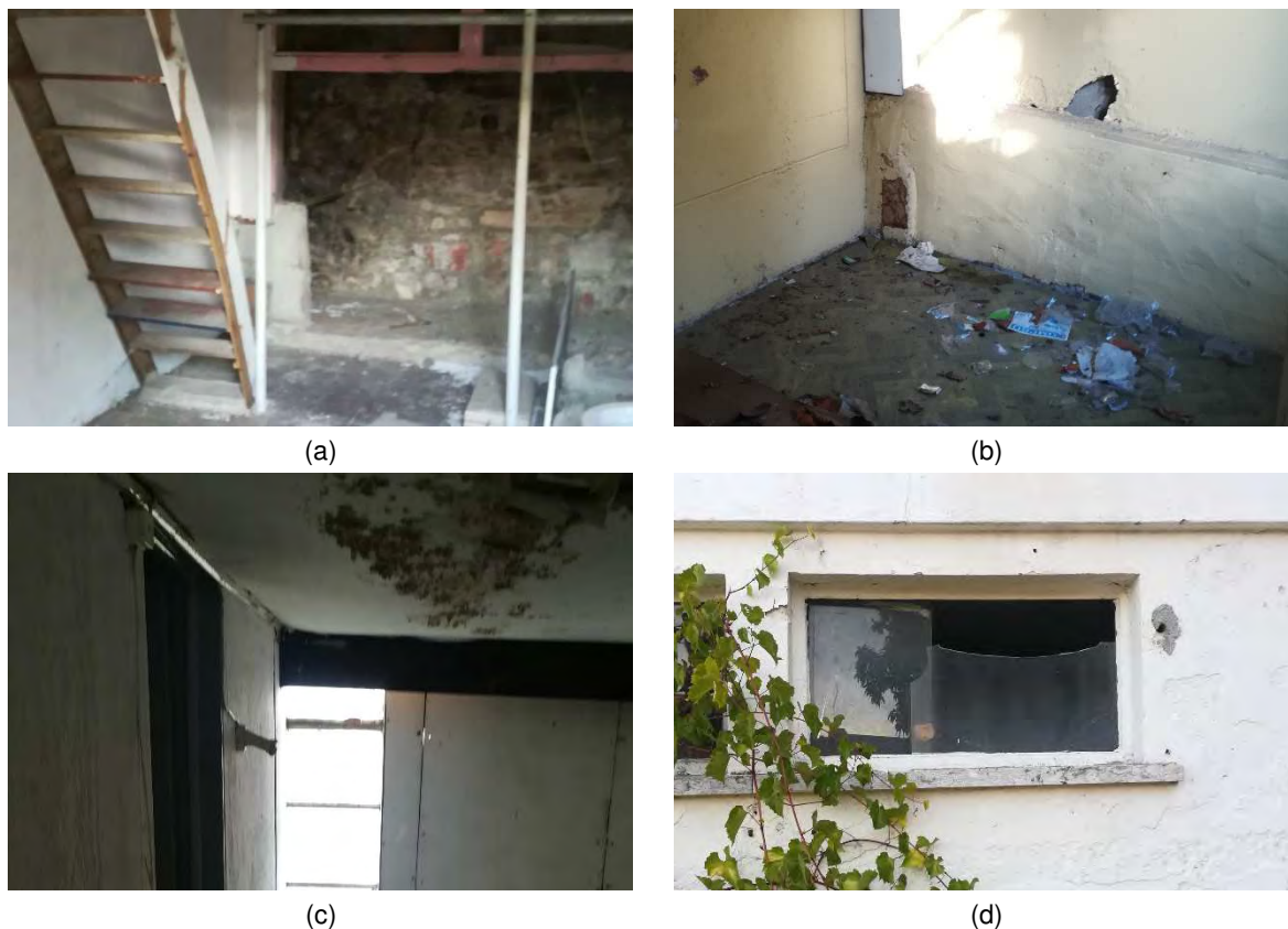
Figura 5.38 – Casa do guarda da EB António Nobre: escadas com deficiente estabilidade (a); pavimentos e paredes degradados (b); sintomas das infiltrações pela cobertura e deformação do forro do teto (c); e vidro partido em janela do r/c (d)
