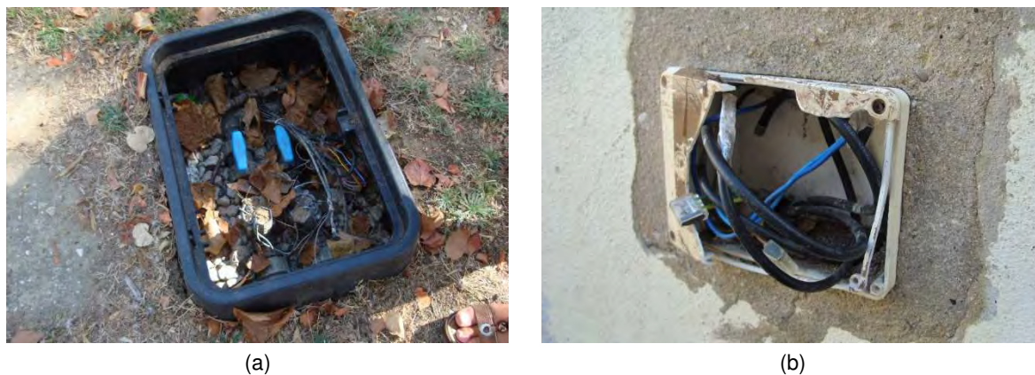
Figura 5.34 – Exemplos de elementos elétricos acessíveis: EB Paulino Montez (a); EB Santo Condestável (b)
