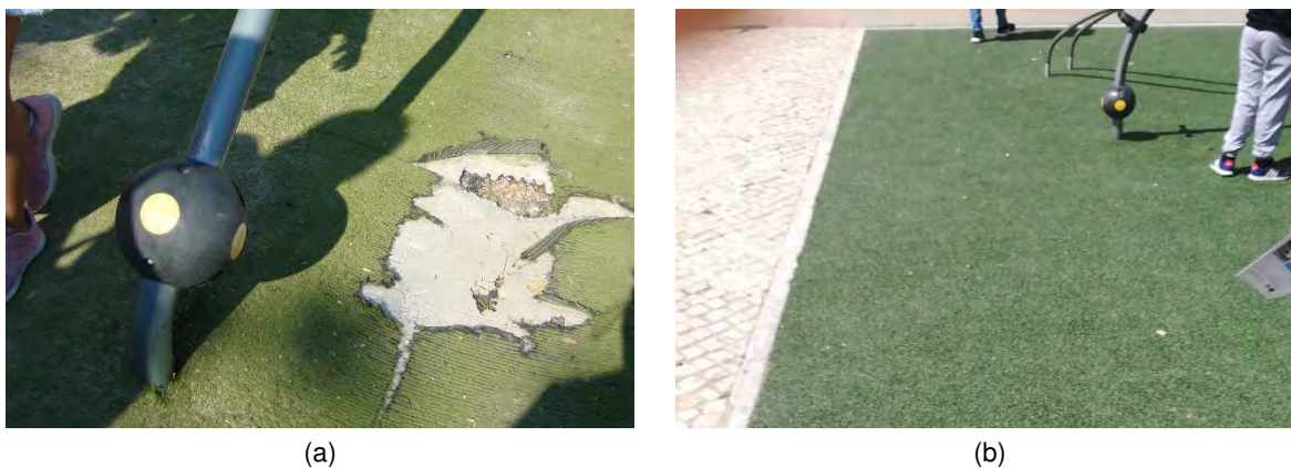
Figura 6.64 – Pavimento do equipamento de recreio: situação em 2018-10-11 (a); situação em 2019-05-21 (b)
