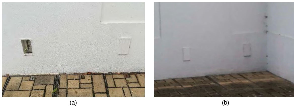
Figura 6.79 – Caixa de instalação elétrica: situação em 2018-11-06 (a); tampa colocada, em 2019-05-21 (b)
