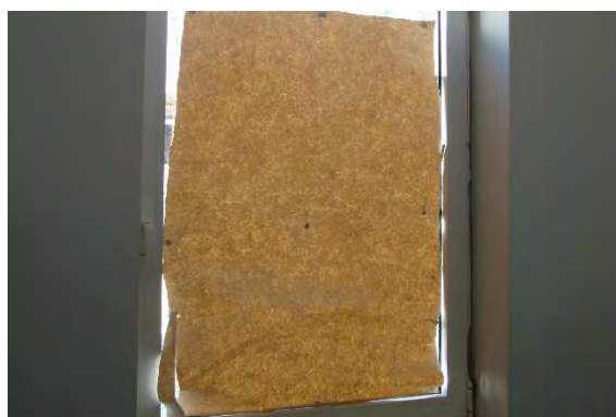
Figura 5.26 – Folha de papel colada em vidro em janela da EB do Bairro do Armador
