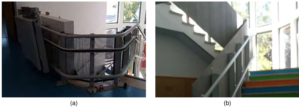
Figura 6.41 – Corrimão de escadas interiores escalável: situação em 2018-10-04 (a); situação em 2019-05-30 (b)
