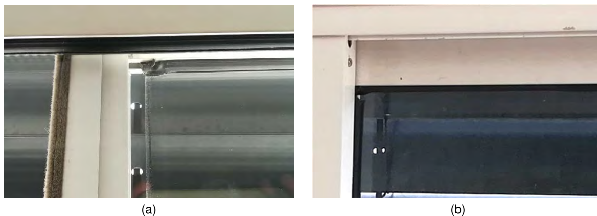
Figura 6.30 – Janela da sala 17: situação em 2018-09-11 (a); janela reparada, em 2019-05-21 (b)
