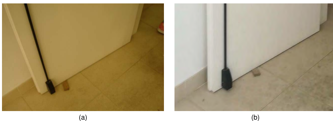
Figura 6.6 – Portas corta-fogo com calços de travamento: situação em 2018-09-25 (a); situação inalterada em 2019-05-30 (b)
