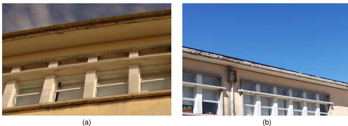
Figura 6.24 – Palas de betão armado do edifício mais recente: situação em 2018-10-23 (a); situação em 2019-05-30 (b)
