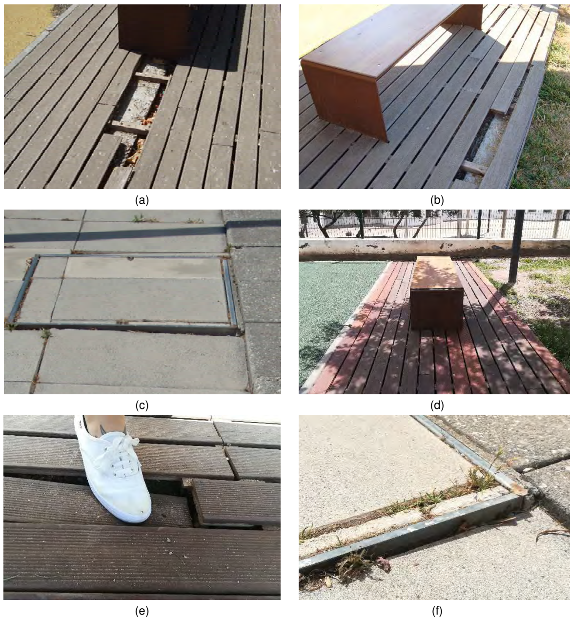
Figura 6.11 – Pavimento exterior: situação em 2018-09-11 (a) a (c); situação em 2019-05-30 (d) a (f)
