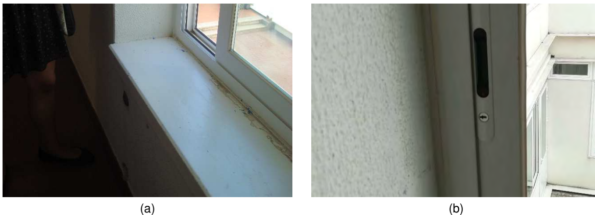
Figura 6.67 – Janelas do 1.º piso: situação em 2018-10-11 (a); situação em 2019-05-21 (b)
