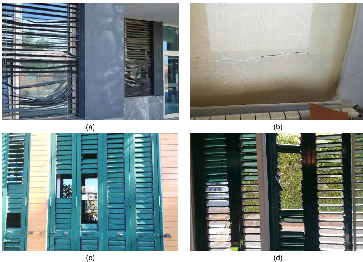
Figura 5.20 – Exemplos de dispositivos de sombreamento com anomalias: EB das Galinheiras (a); JI Bairro Padre Cruz (b); EB Prista Monteiro (c) e (d)
