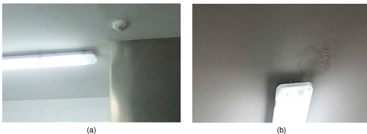
Figura 6.46 – Infiltração na cozinha: situação em 2018-10-16 (a); situação em 2019-05-30 (b)
