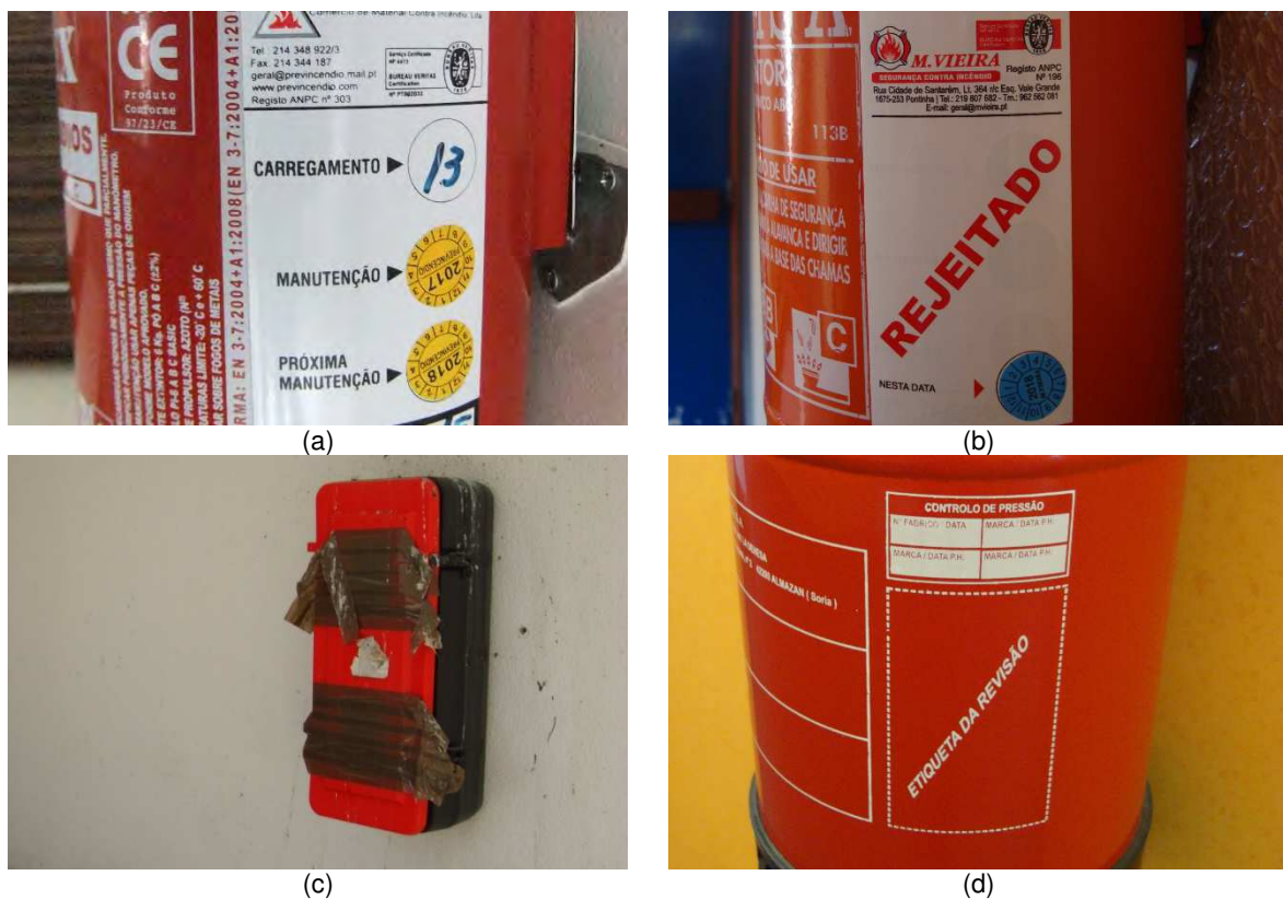
Figura 5.22 – Exemplos de equipamentos de combate a incêndio com prazos de validade ultrapassados ou inoperacionais: EB Lumiar – Alto da Faia (a); EB Homero Serpa (b); EB Manuel Teixeira Gomes (c); e EB Quinta dos Frades (d)
