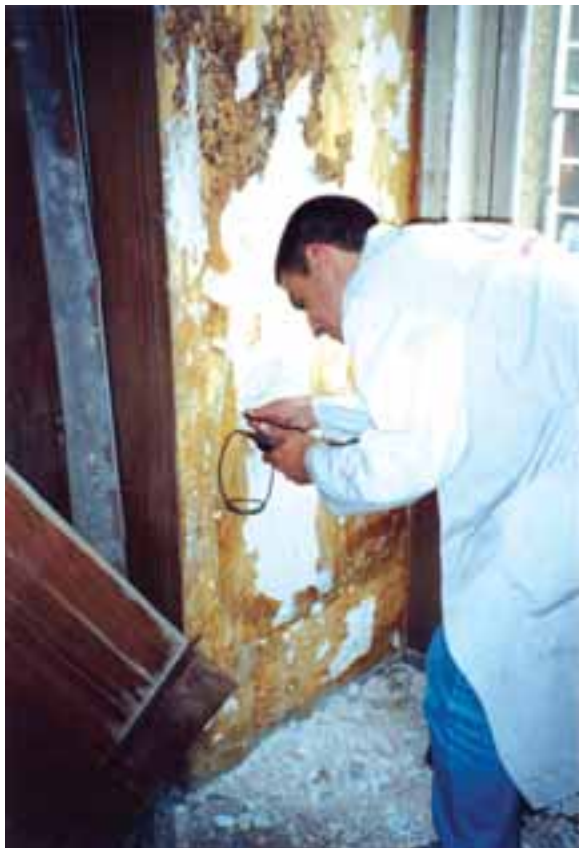
Fig. 4 – Avaliação qualitativa do teor de humidade em paredes.
