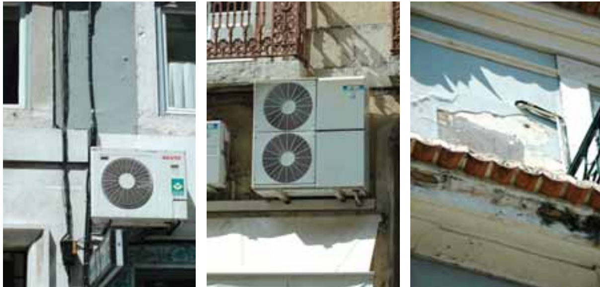
Fig. 22 – Unidades de climatização (condensação).
