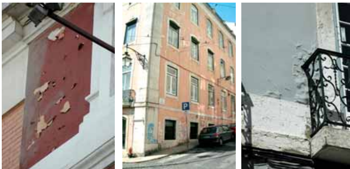
Fig. 21 – Exemplos de efeitos de destacamentos de tintas texturadas dos suportes.
