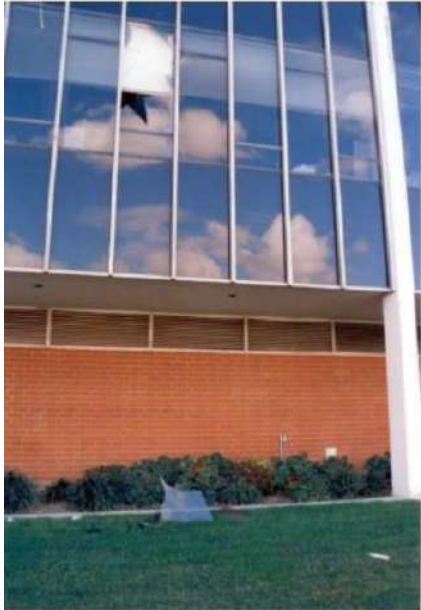
Danos em vidro não temperado. Sismo 1994 Northridge
