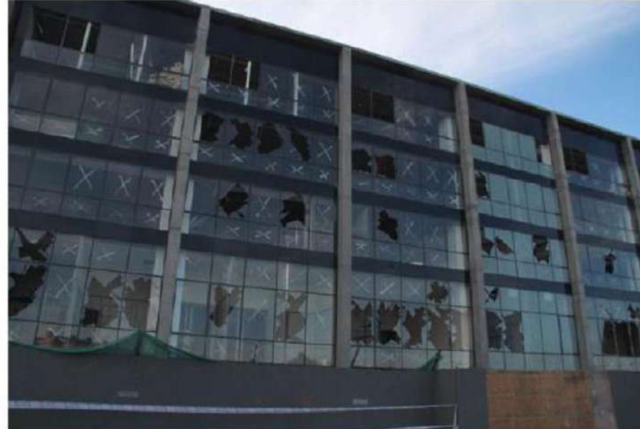
Danos em vidro temperado. Sismo 2010 Chile
